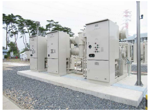
写真 2.1.19-6 新設 GIS 設備
