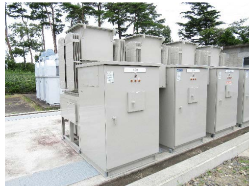
写真 2.1.19-4 新設高圧進相コンデンサ
