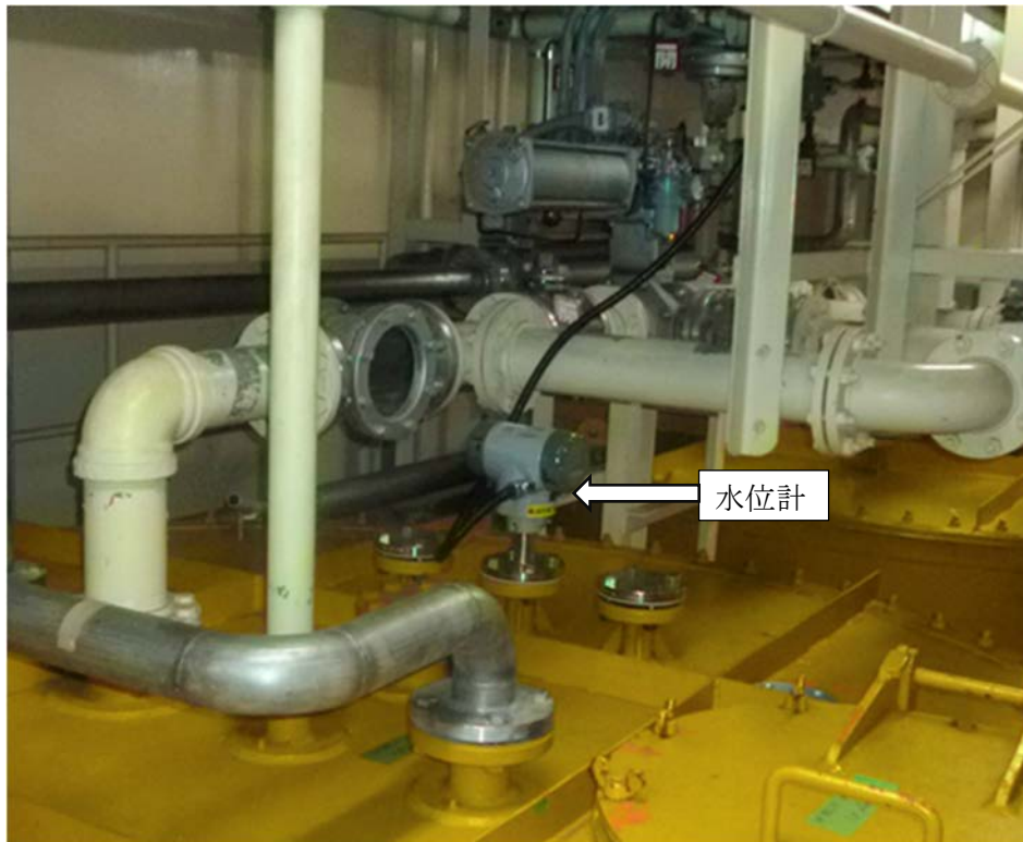
写真 2.1.6-1 廃液貯槽水位計更新後
