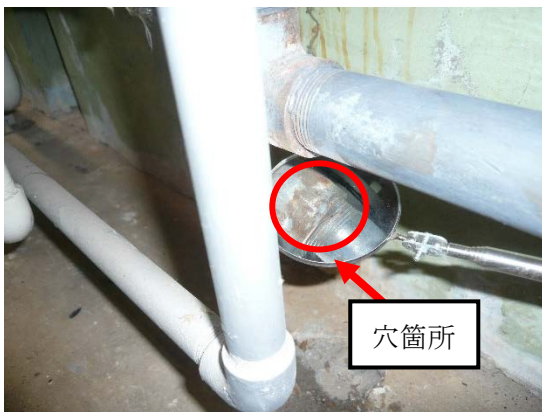
写真 2.1.18-1 機械室蒸気管（補修前）
