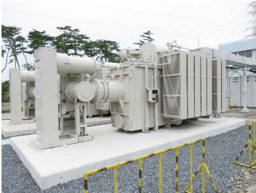
写真 2.1.19-5 新設 No. 1 BANK 変圧器
