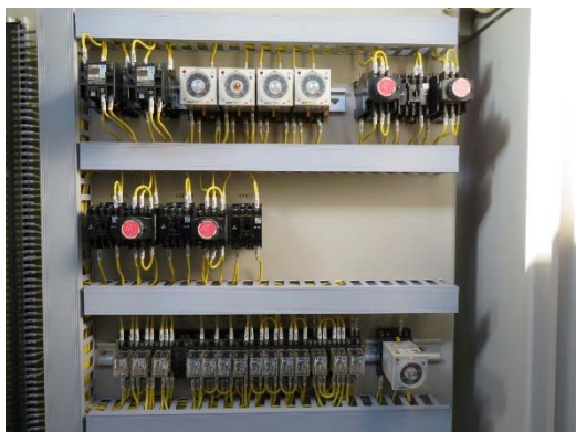
写真 2.1.3-1 更新前の制御リレー
