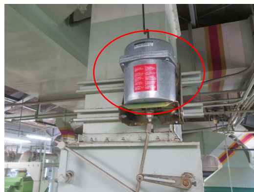
写真 2.1.3-4 更新後のダンパ操作器
