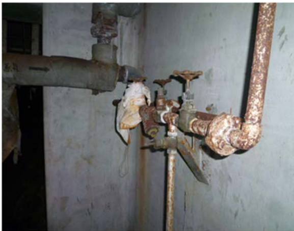
写真 2.1.14-1 蒸気配管一式補修前
