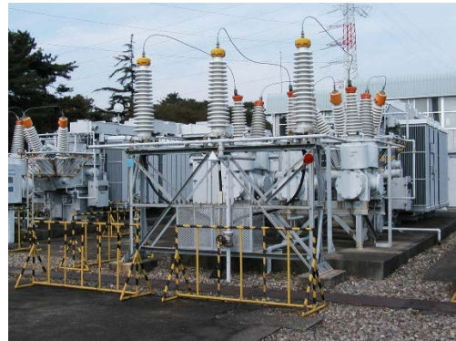
写真 2.1.19-2 既設 No. 1・2 BANK 変圧器
