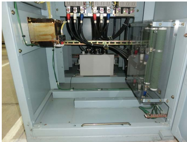
写真 2.1.4-2 NSRR ターボ冷凍機進相コンデンサーの設置状況
