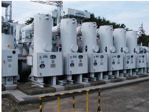
写真 2.1.19-1 既設 GIS 設備（一部使用中）
