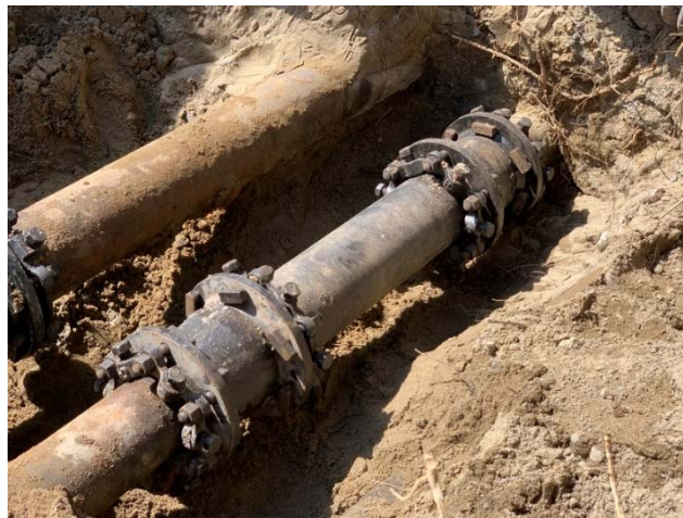
写真 2.1.20-2 汚染除去場東側工水管漏洩補修状況
