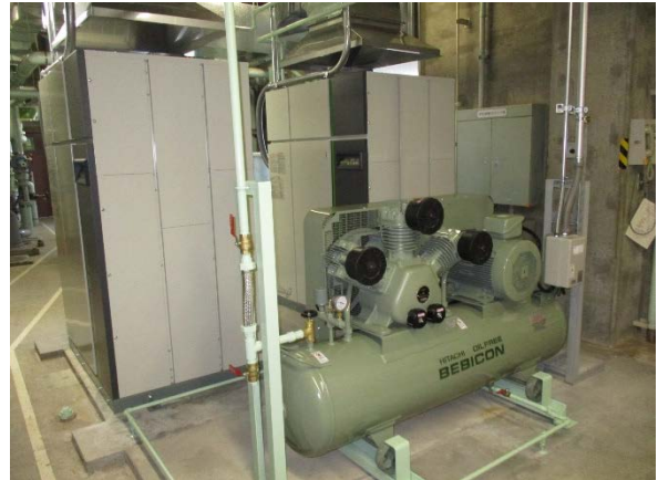
写真 2.8.4-2 更新後の空気圧縮機 (奥の2台がスクロール式)
