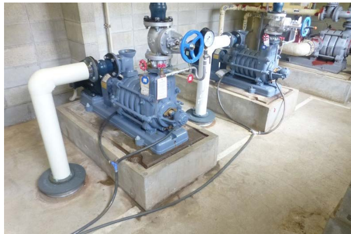
写真 2.1.15-1 更新した工水揚水ポンプ
