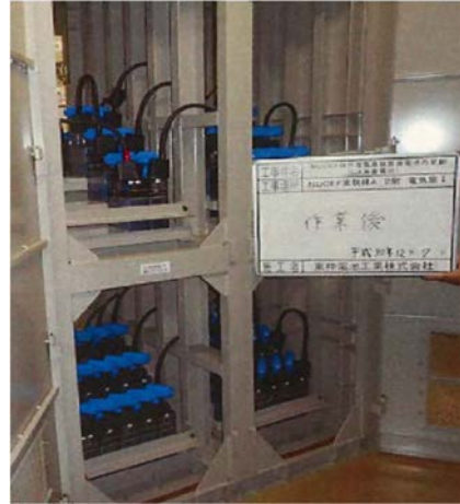
写真 2.1.5-2 UA 系蓄電池 (交換後)
