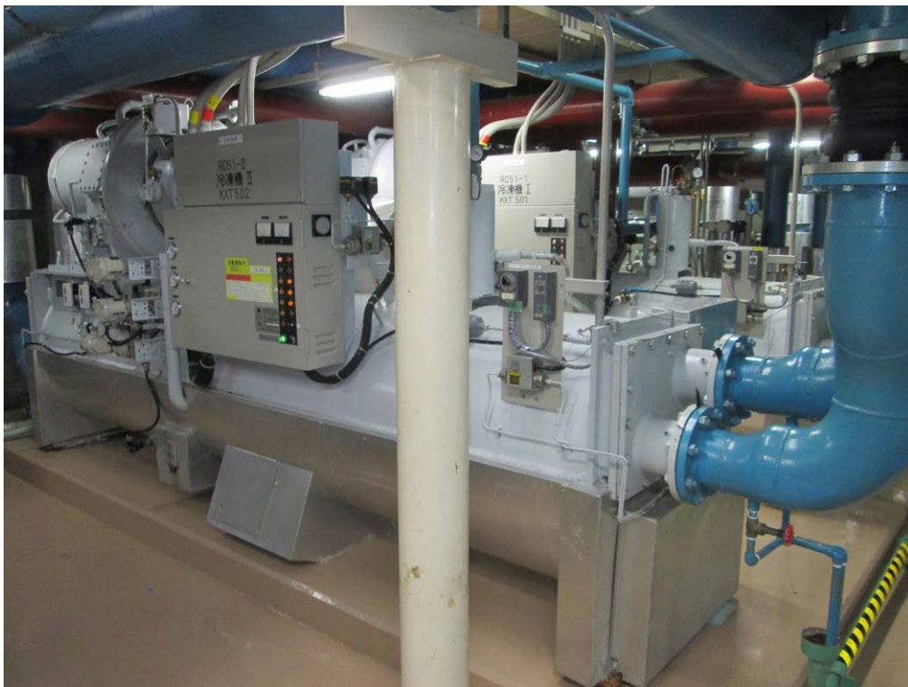
事務管理棟冷凍機(更新前)
