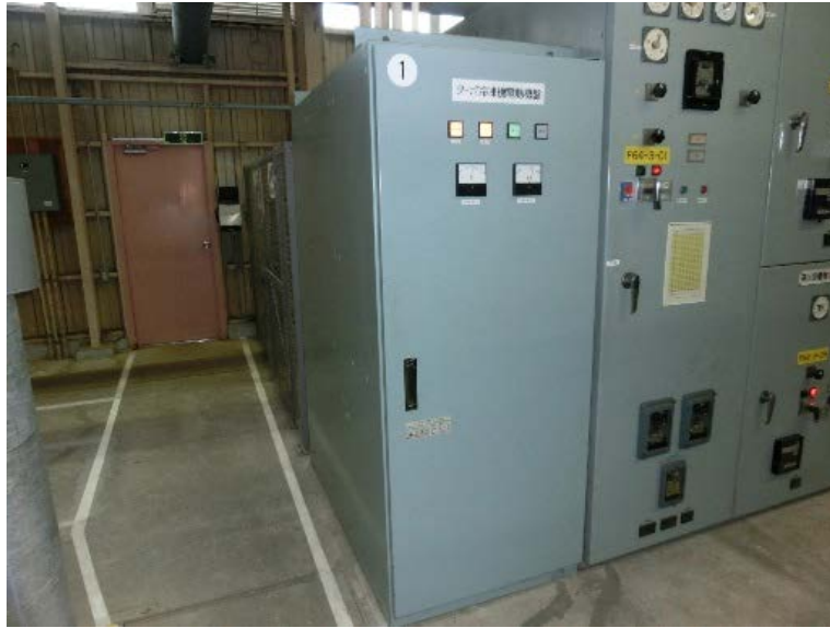
写真 2.1.4-1 NSRR ターボ冷凍機盤
