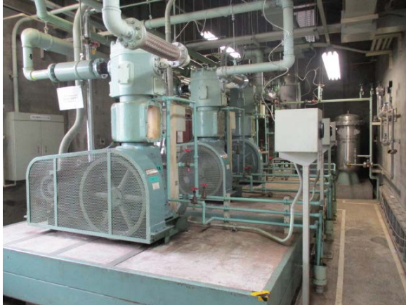
写真 2.8.4-1 更新前の空気圧縮機
