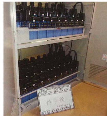
写真 2.1.5-4 UC 系蓄電池 (交換後)
