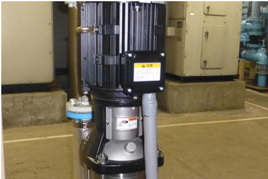
写真 2.1.11-1 更新したNo.1 浄水揚水ポンプ
