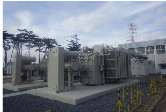
変圧器、ガス遮断器（更新後）
