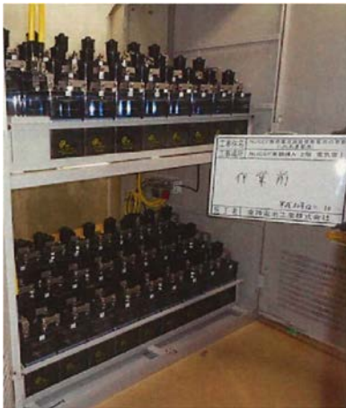
写真 2.1.5-3 UC 系蓄電池 (交換前)
