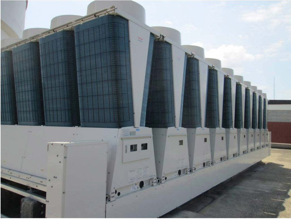
事務管理棟冷凍機(更新後)
