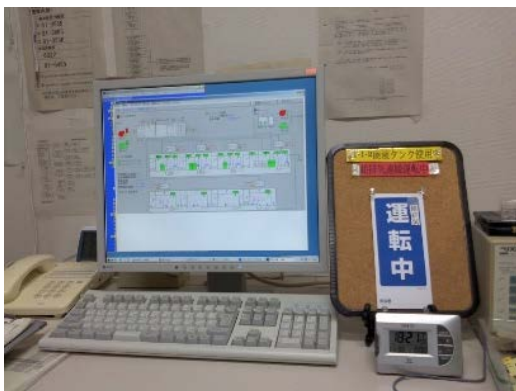
中央監視装置更新前
