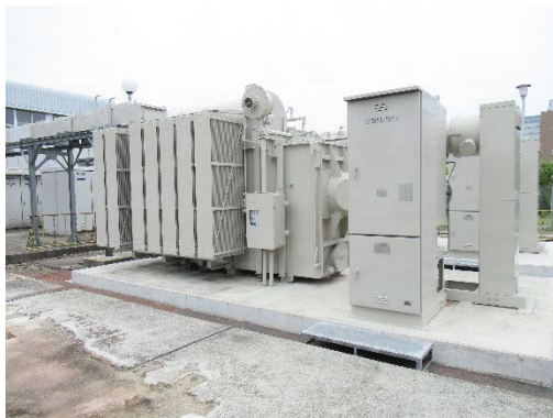
写真 2.1.19-3 新設 No. 2 BANK 変圧器
