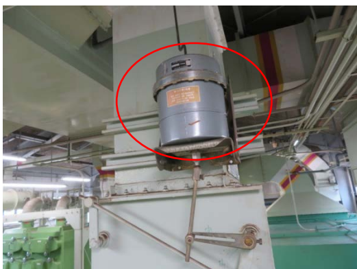
写真 2.1.3-3 更新前のダンパ操作器
