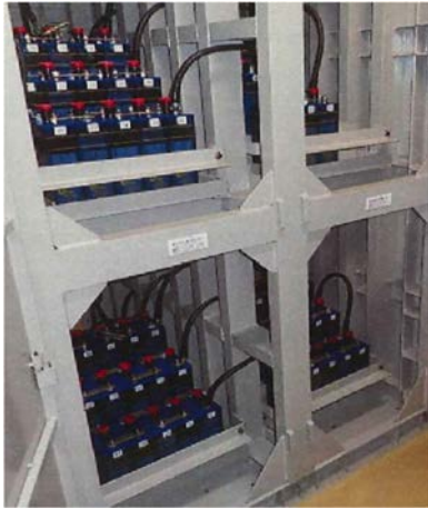
写真 2.1.5-1 UA 系蓄電池 (交換前)
