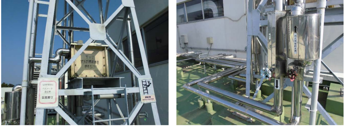
写真 2.1.9-2 屋外消火栓補給水槽と凍結防止対策を施した給水配管(一番手前)
