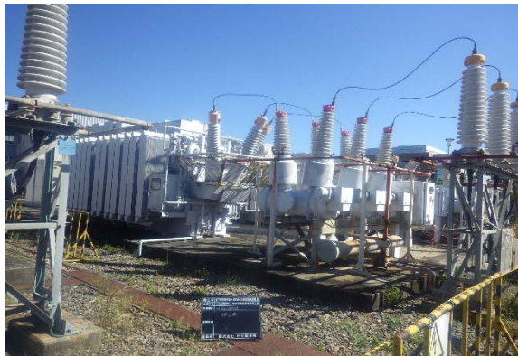
変圧器、ガス遮断器（更新前）
